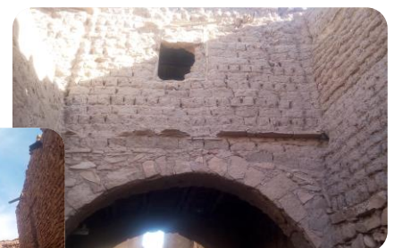
Figure 70: Chambre pont SOURCE: trouver par l'auteur
