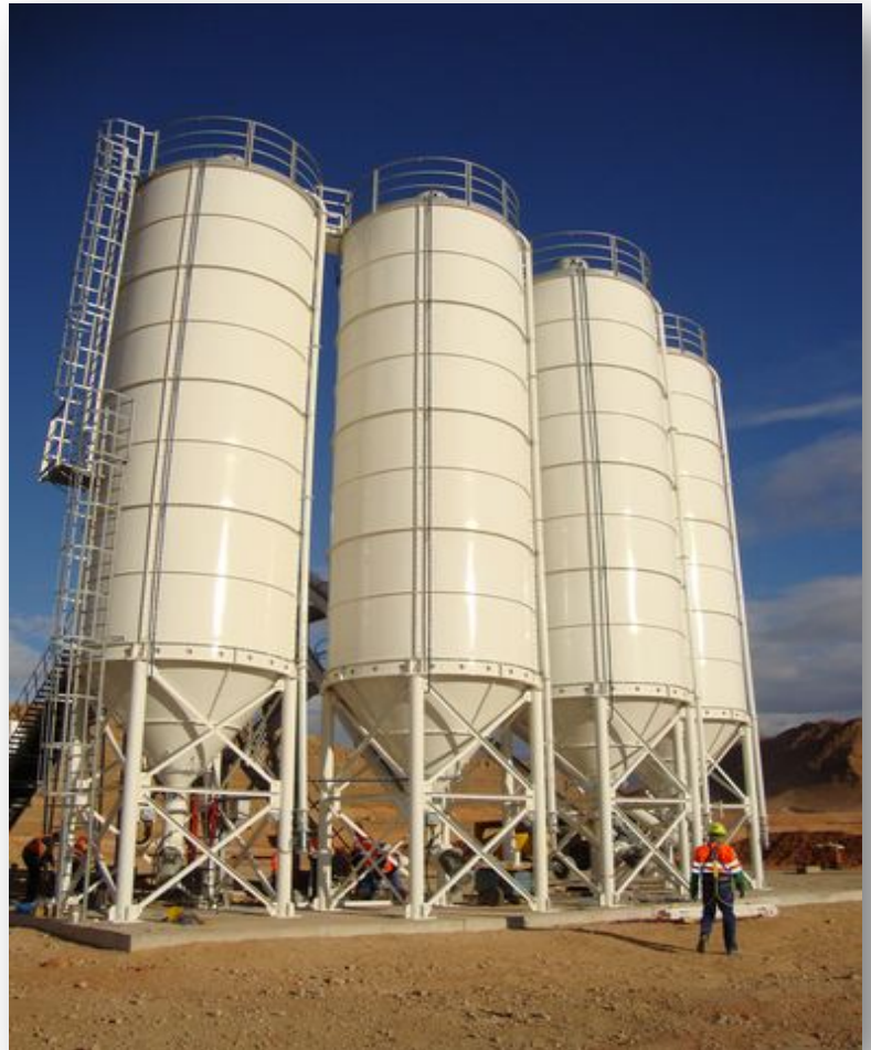
Figure03 : silos forme cylindrique à ciment avec accessoires.
