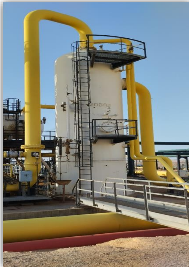
Figure II-2 : Vue extérieure d'un séparateur vertical
