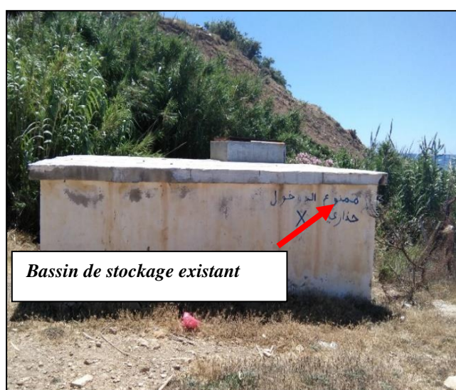
Figure.12 : Bassin de stockage de l'eau de la source « SABRA »
