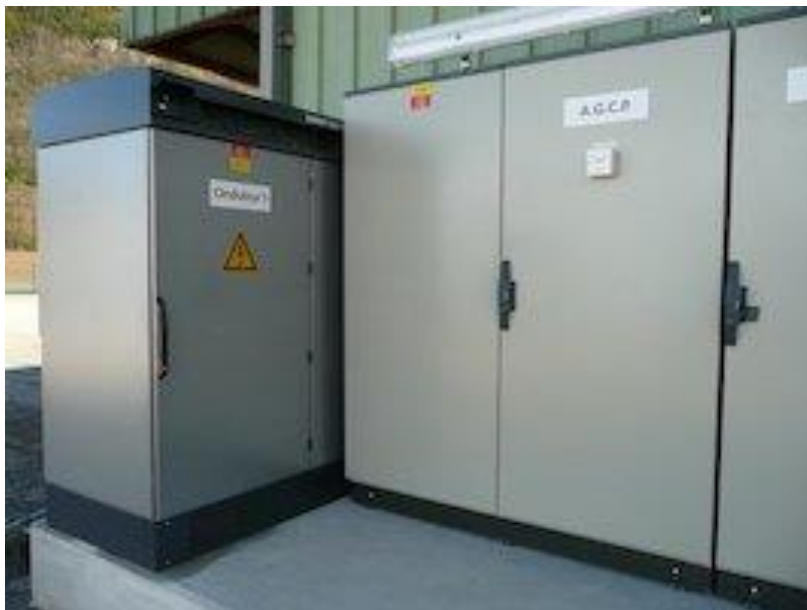
Figure (II.10) : Onduleur central
