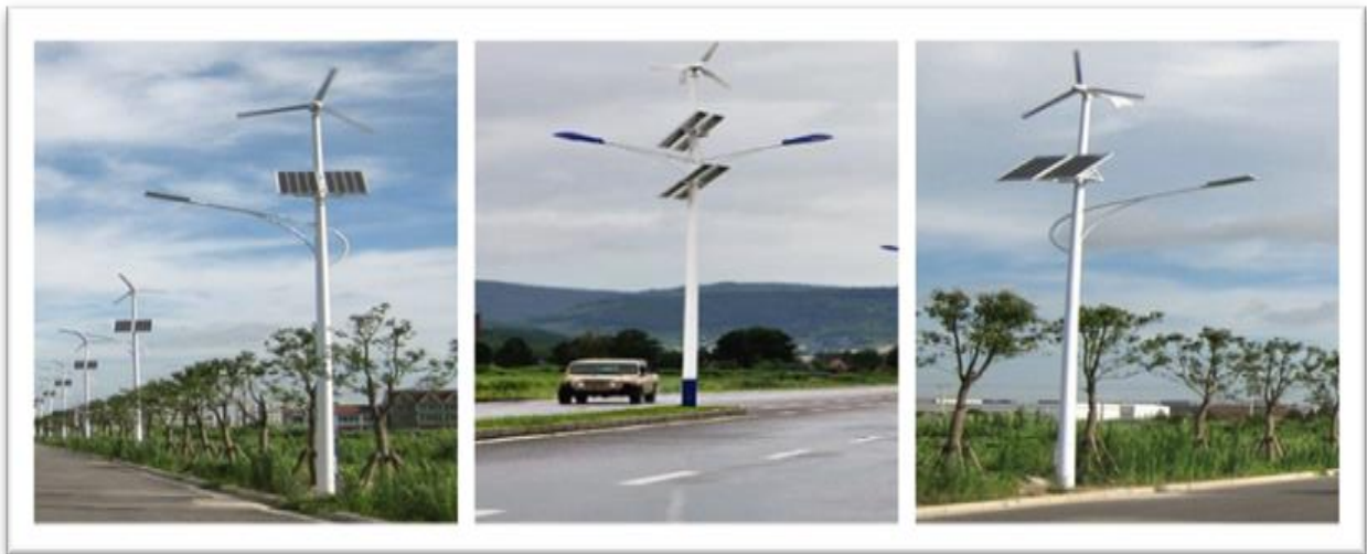
Figure II-5 Lampadaires utilisant l'énergie hybride éolienne et solaire
