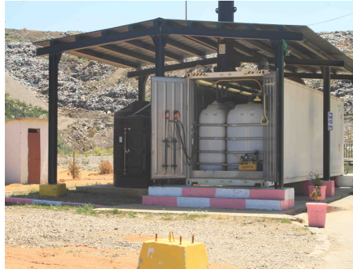
Figure.5.a : Station d'épuration de lixiviat par osmose inverse
