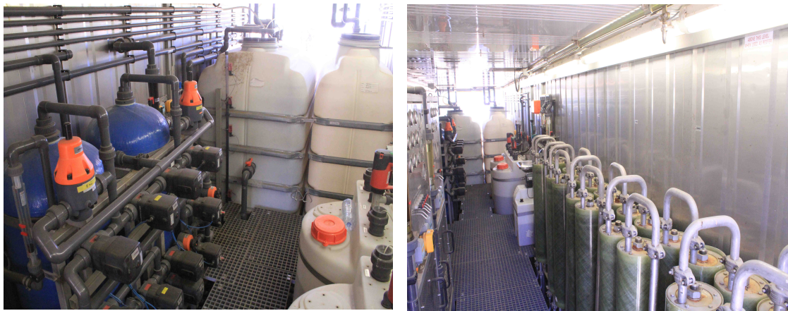
Figure.5.b : Filtre à sable et cartouche en prétraitement à l'osmose inverse
