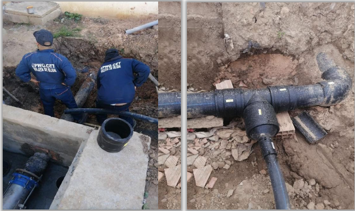
Figure III-10 : Alimentation par une conduite de l'eau épurée pour le cet [43].
