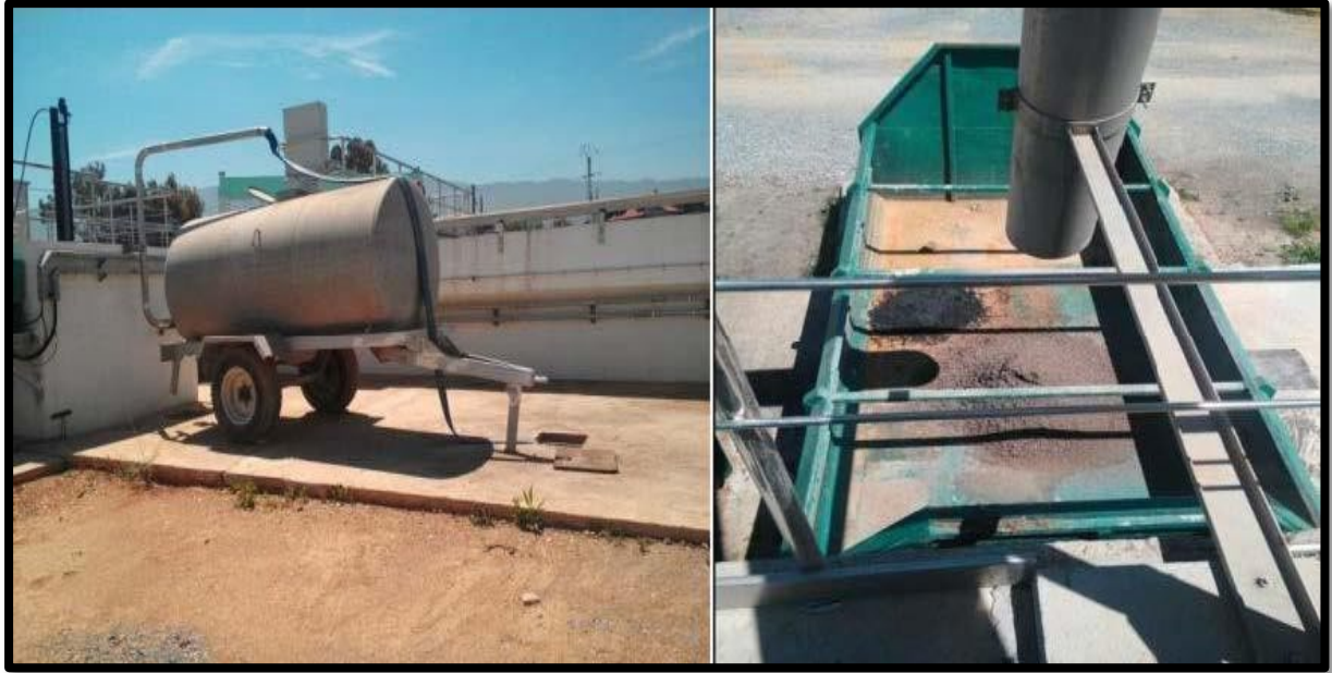
Figure II-7 : Stockage des graisses dans une citerne et classification des sables dans une benne [44].
