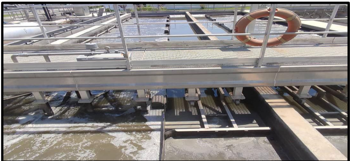
Figure II-6 : : Ligne de dessableur -déshuileur.
