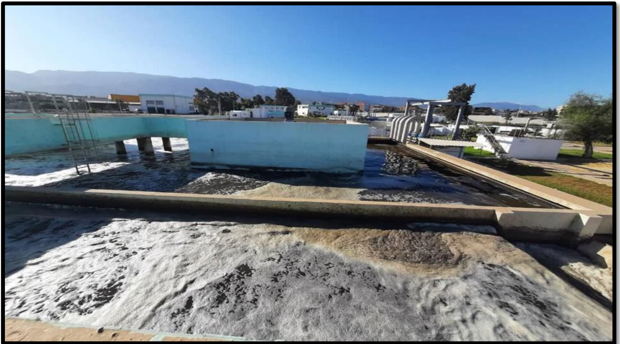
Figure II-8 : Bassin d'aération de la STEP de Béni Mered.
