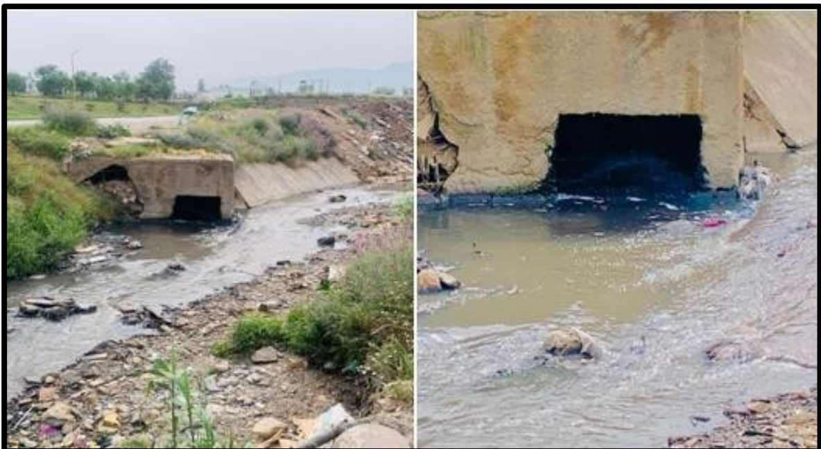
Figure II-11 : Sortie de l'eau épurée [44].
