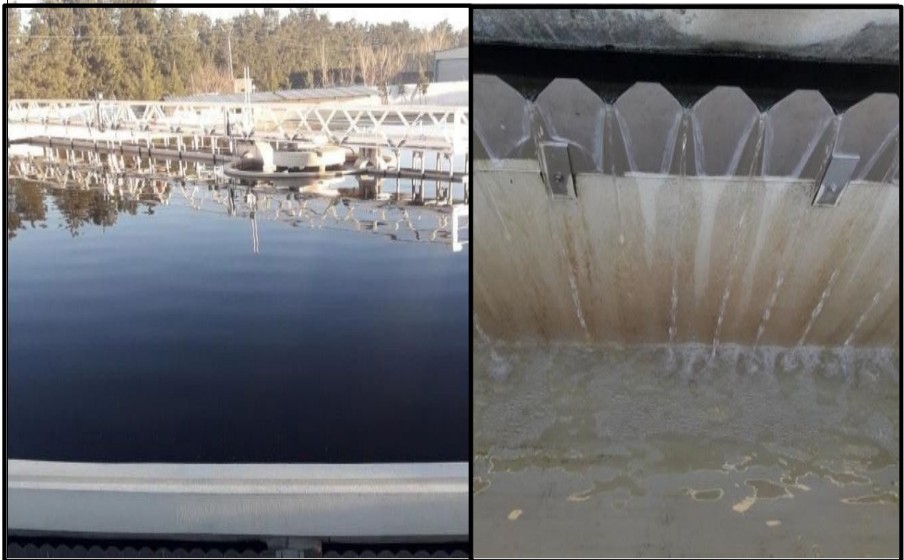
Figure II-9 : Clarificateur de la STEP de Béni Mered.
