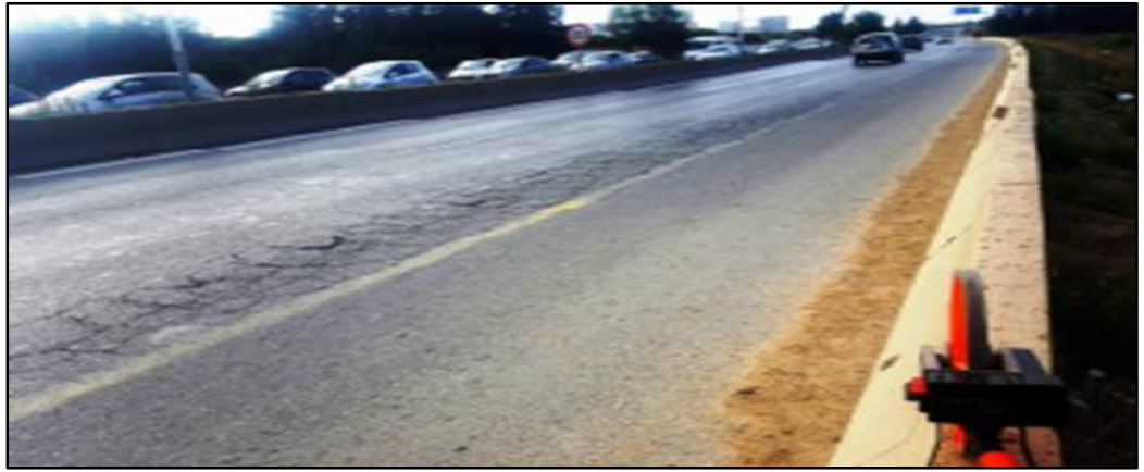
Figure IV.4 Faiénçage à mailles fines avec affaissement
