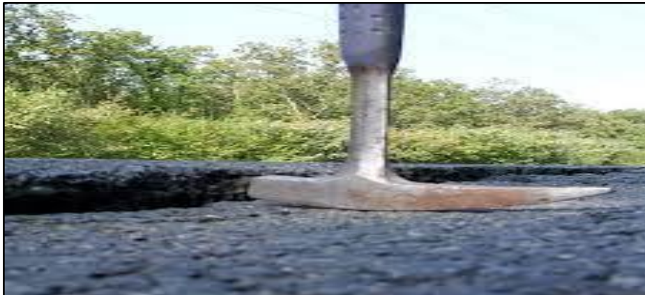
Figure I. 11: Exemple d'un gonflement d'une chaussée
