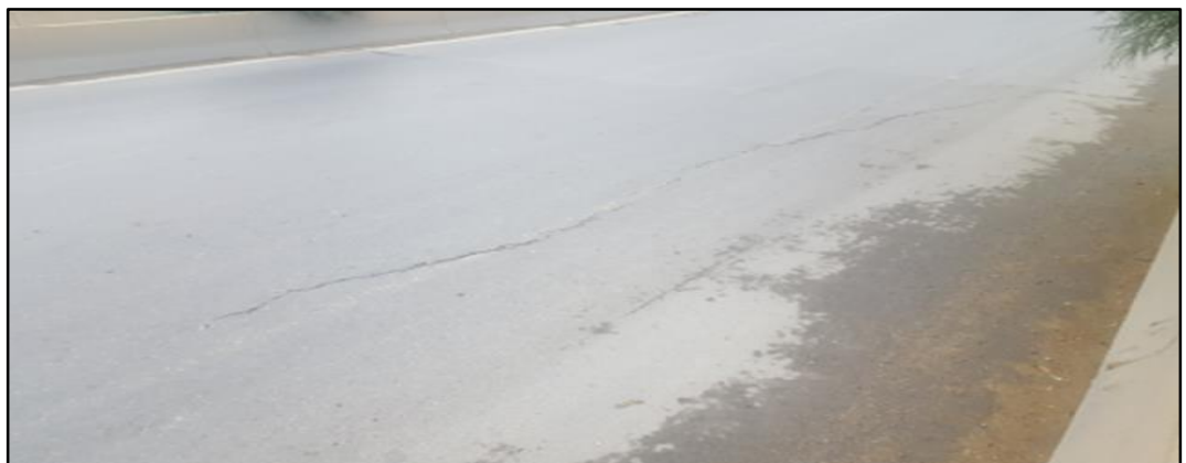
Figure IV.6 : Fissure longitudinale apparente sur la rive droite
