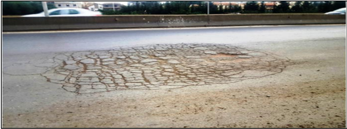
Figure IV.9 : Faiénçage localisé accompagné par des arrachements
