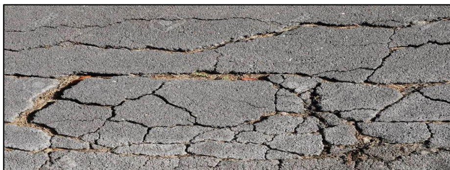
Figure I.7: Tracés D'épaufure dans une chaussée
