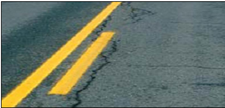
Figure I.4: Fissure longitudinale dans une chaussée [01]
