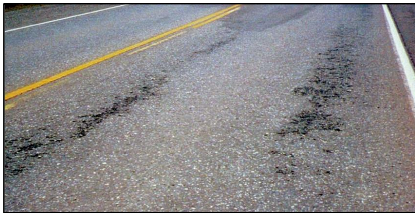
Figure I.16 : Arrachement sus forme de plumage
