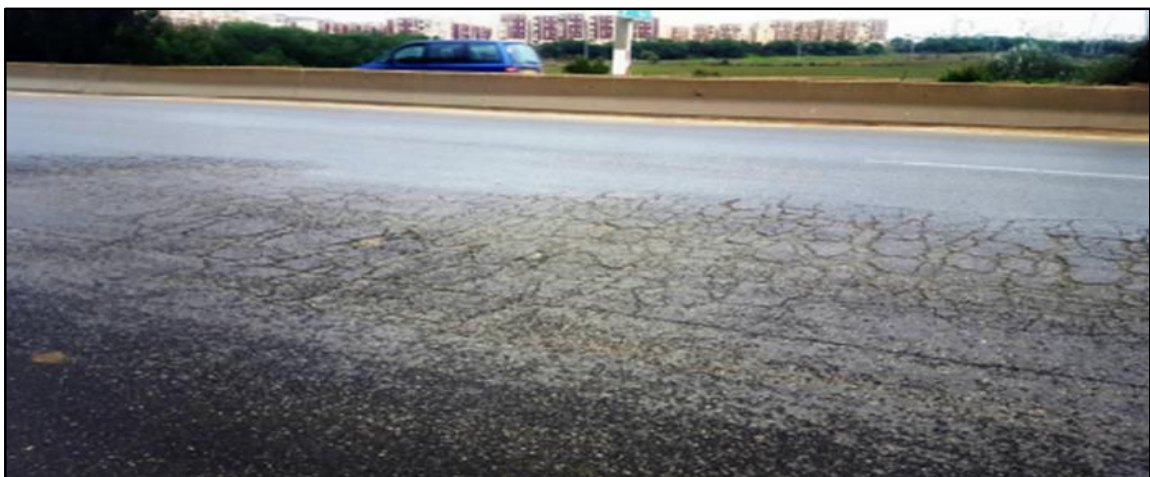
Figure IV.8 Faïençage généralisé sur la voie de droite
