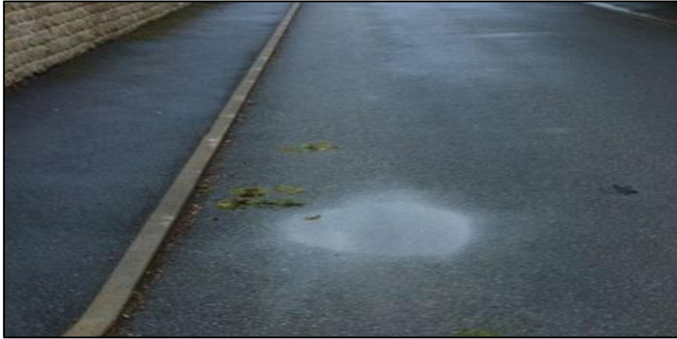
Figure I. 10: Flache sous forme de tassement
