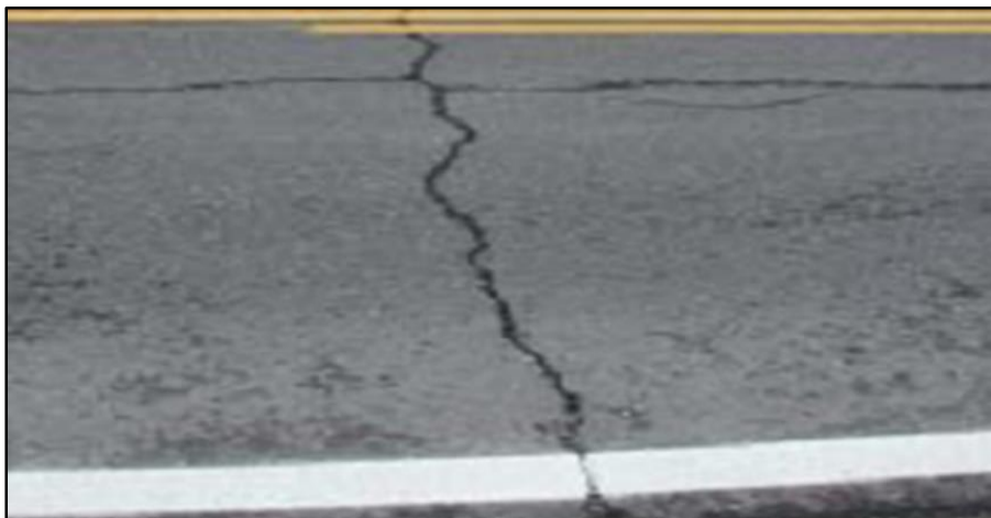
Figure I.3: Fissure transversale au niveau d'une chaussée [01]
