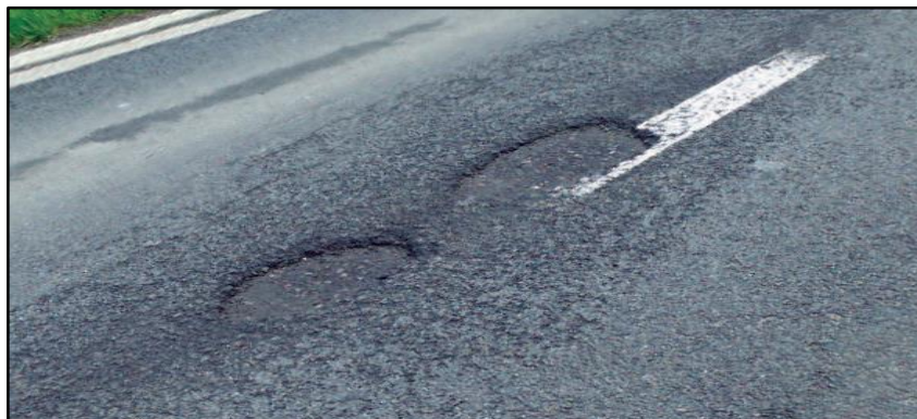
Figure I.13: Désenrobage sur chaussée
