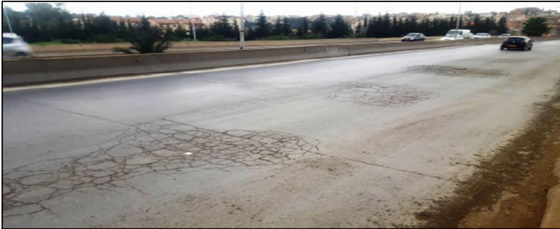
Figure IV.7 : Faïençages multiples sur la voie de droite
