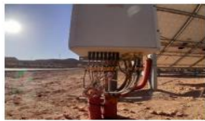
Coffret de protection DC
