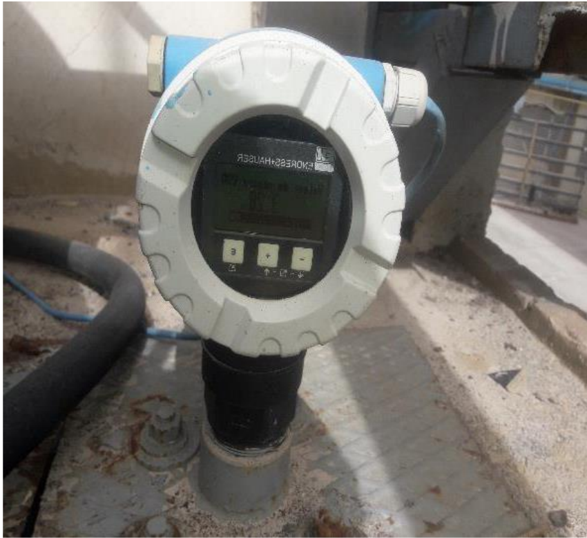
Figure II.15: le capteur de niveau
