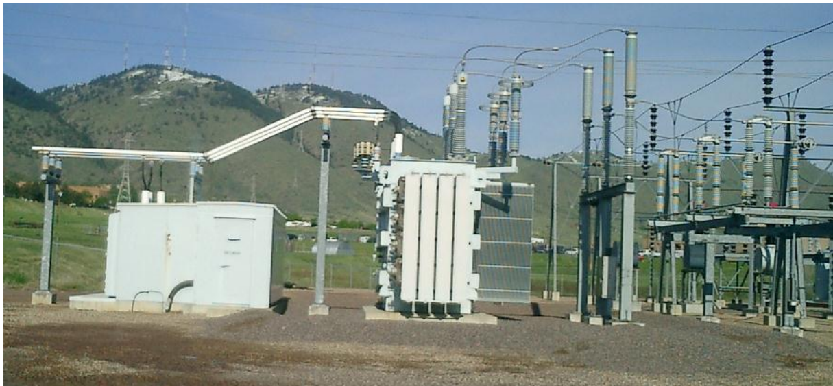
Figure N°11 : Transformateur de puissance.
