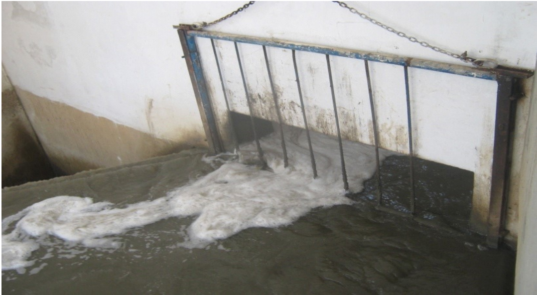
Photo I.2 : Dégrillage grossier de la STEP de Beni-Messous.
