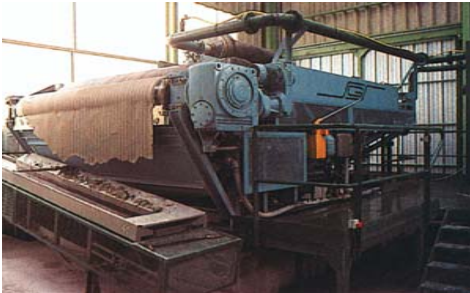
Photo I.2 : Déshydratation des boues par filtre à bande.
