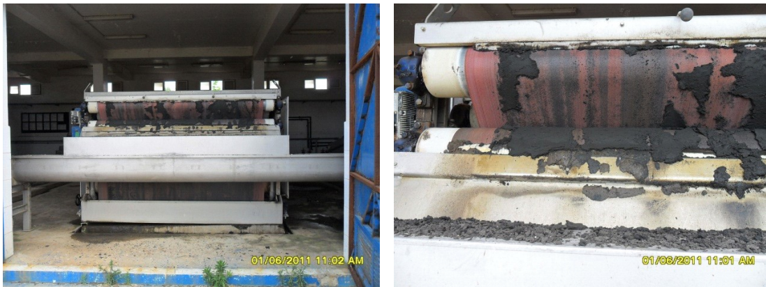
Photo I.7: Déshydratation mécanique des boues de la STEP de Beni-Messous.
