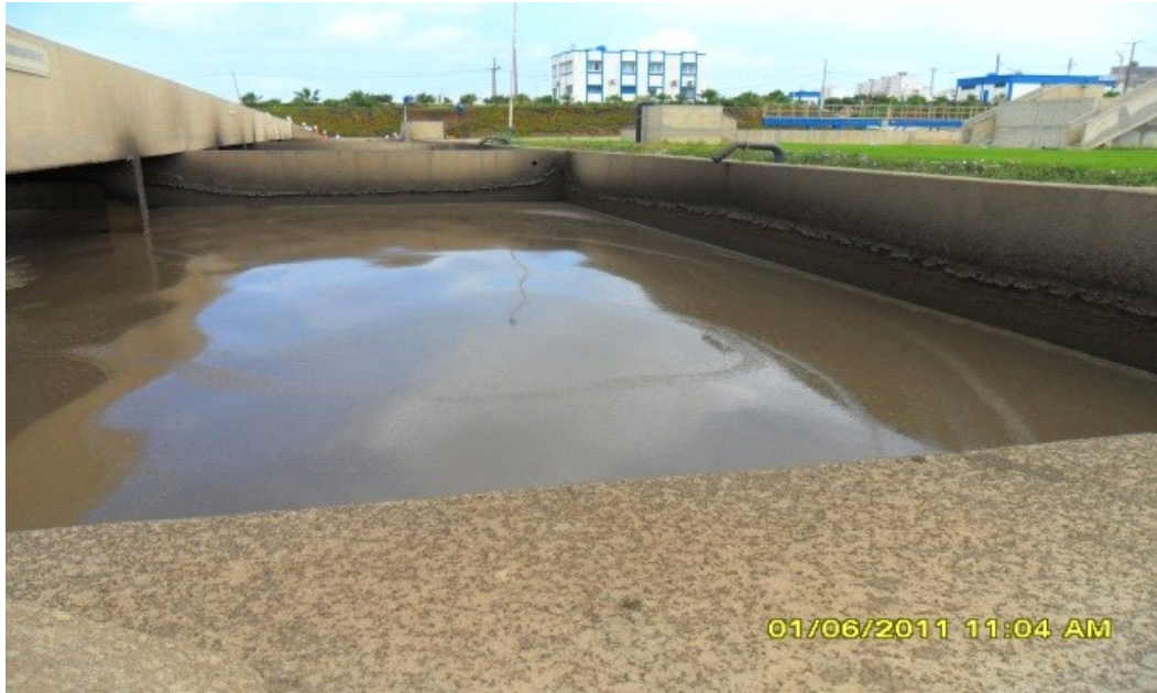
Photo I.6: Bassins de stabilisation des boues de la STEP de Beni-Messous.
