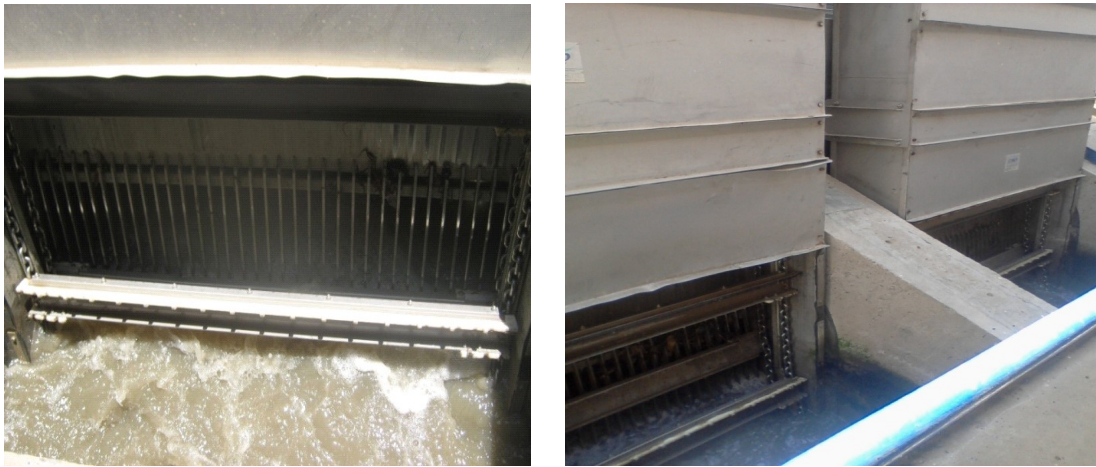
Photo I.3 : Dégrillage fin de la STEP de Beni-Messous.
