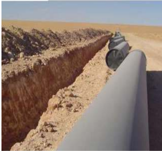
Ligne de pipelines
