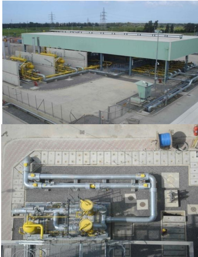
Figure 3.14: Poste de distribution du gaz principal .
