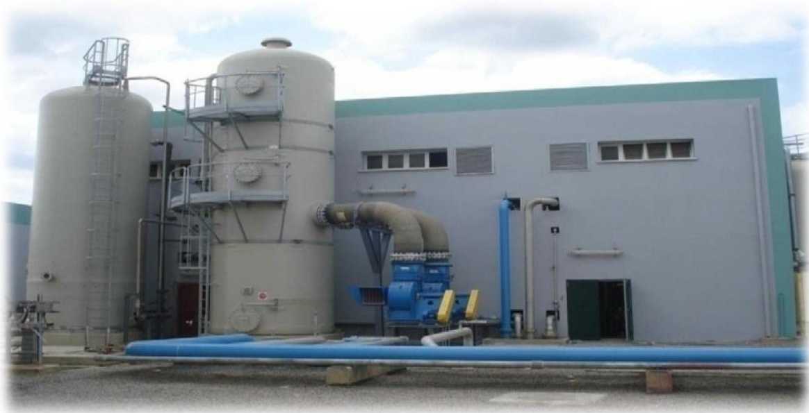
Figure 3.17: Station de production d'eau déminéralisée
