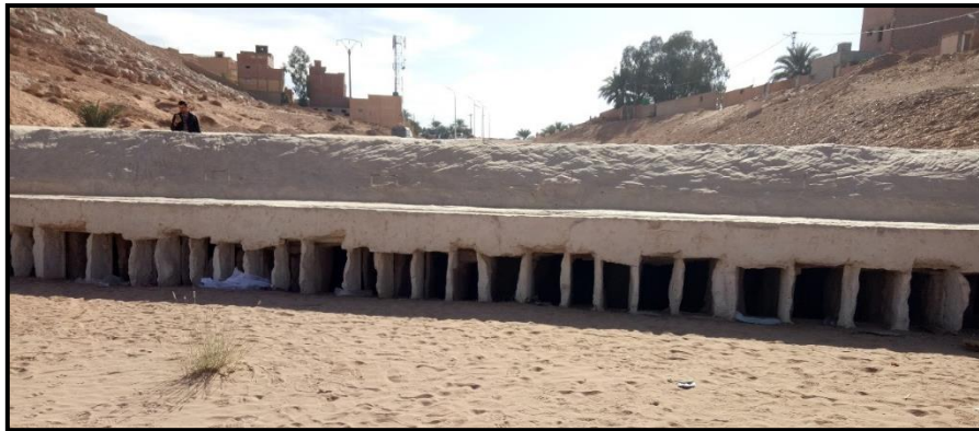
Figure 216: les canaux de récupération et drainage d'eau. Source : auteur durant la visite du site
