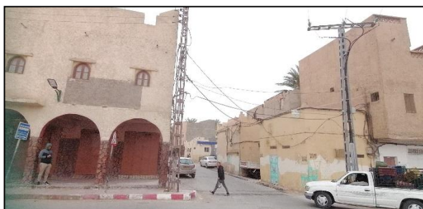
Figure 195: photo des façades dégradé du boulevard. Source : prise par l'auteur
