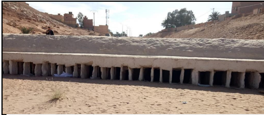
Figure 178: les canaux de récupération et drainage d'eau. Source : auteur durant la visite du site
