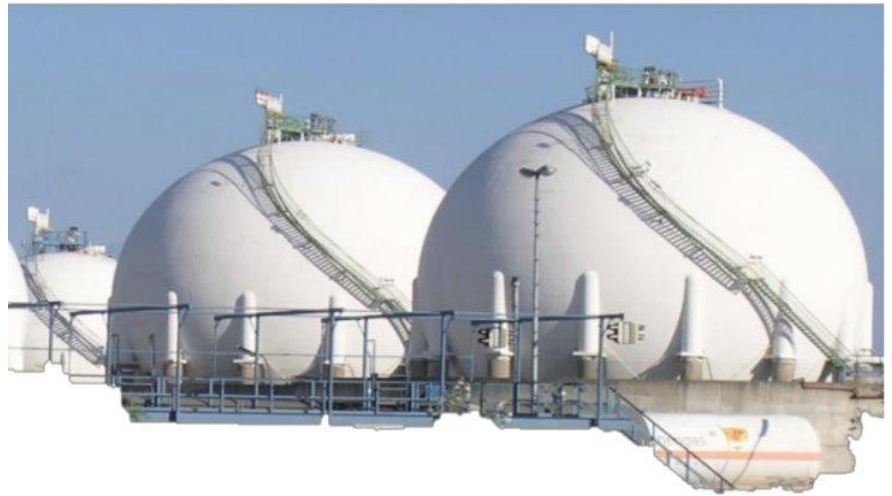
Figure 1.3 : réservoirs sphériques de stockage sous pression. [2]
