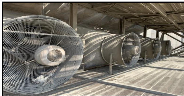
Figure 2-5 : Batterie de ventilation
