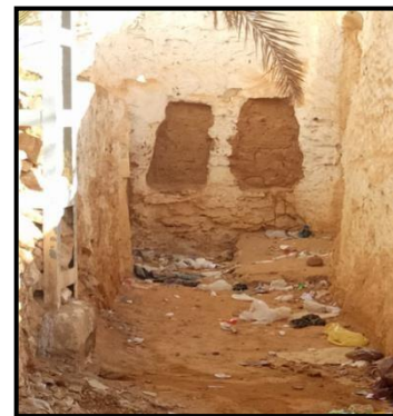
Figure 217: les ouvertures aux pieds des murs de clôture. Source : auteur durant la visite du site
