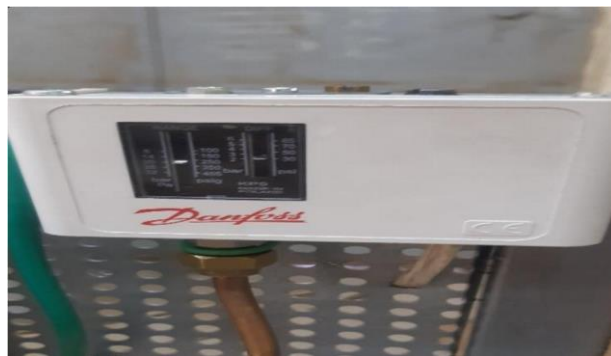
Figure 4.10 : la connexion du pressostat au compresseur
