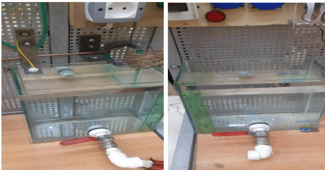
Figure 4.34 : Les tests de circuit hydraulique
