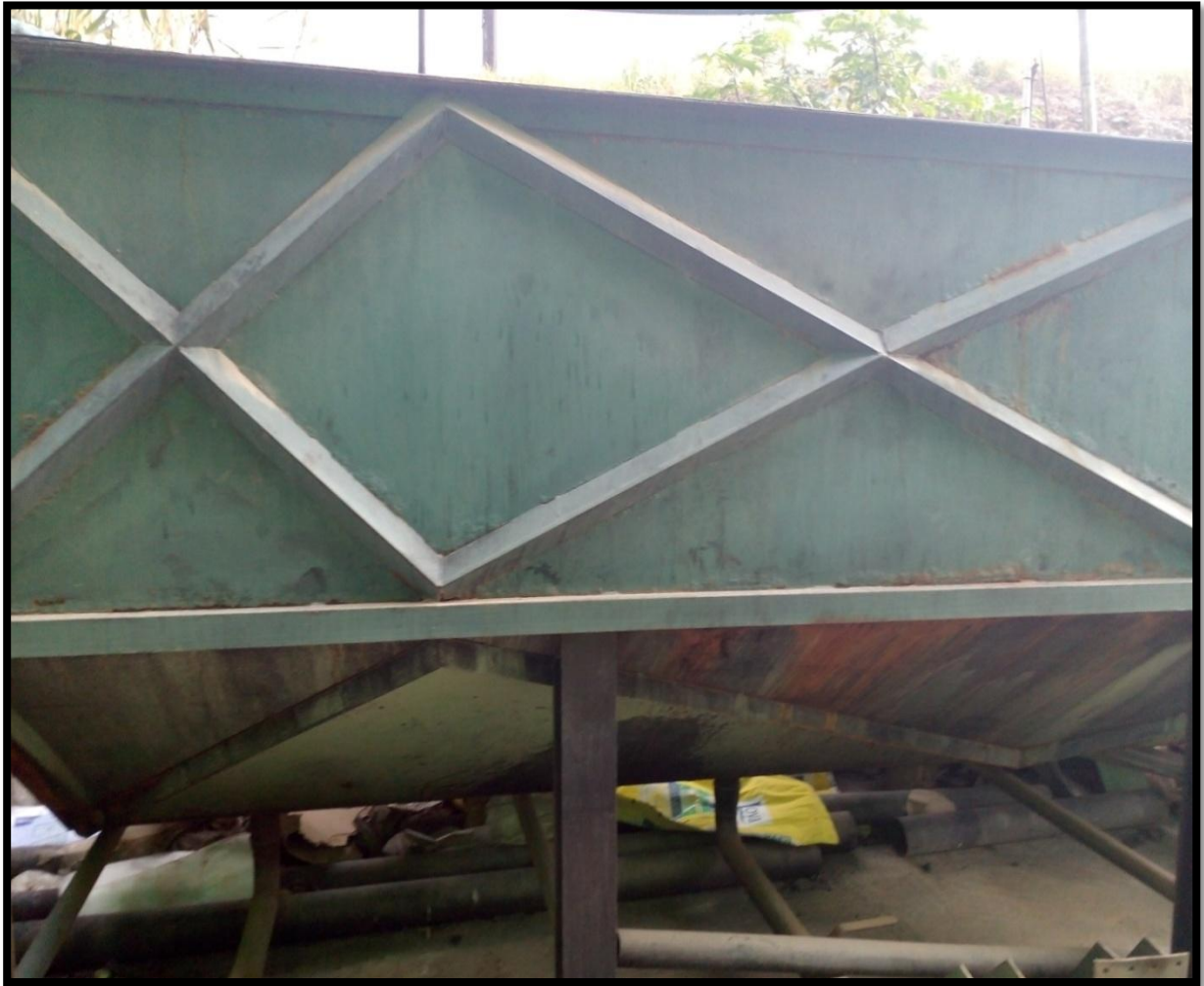
Fig 15 : Station de traitement des eaux de purge(Juin 2016)
