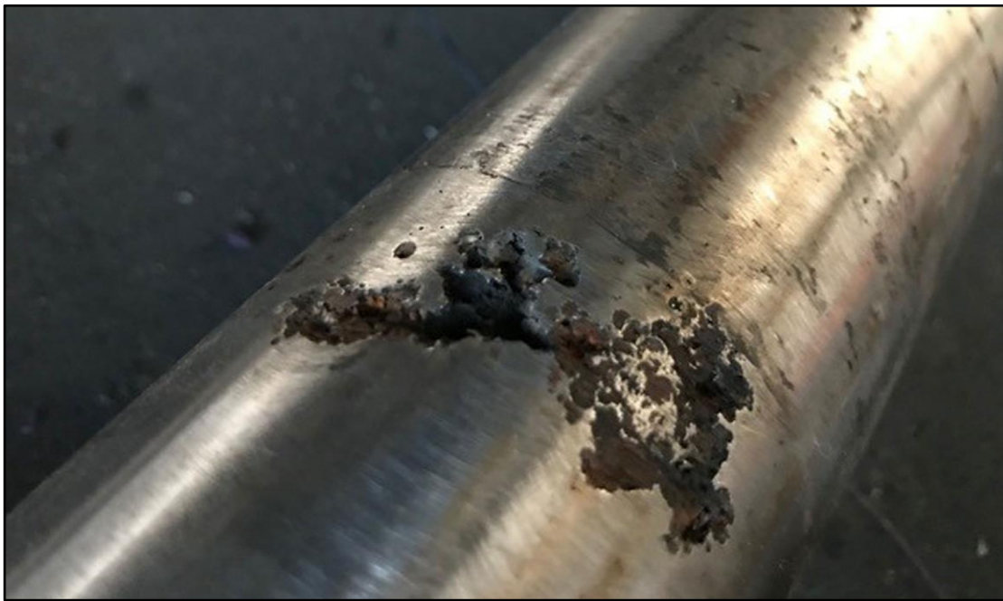
Figure II.5. La corrosion sous revêtement
