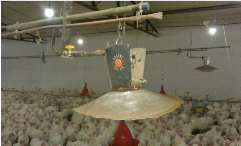
Photo n°09 : Radiant à gaz.
