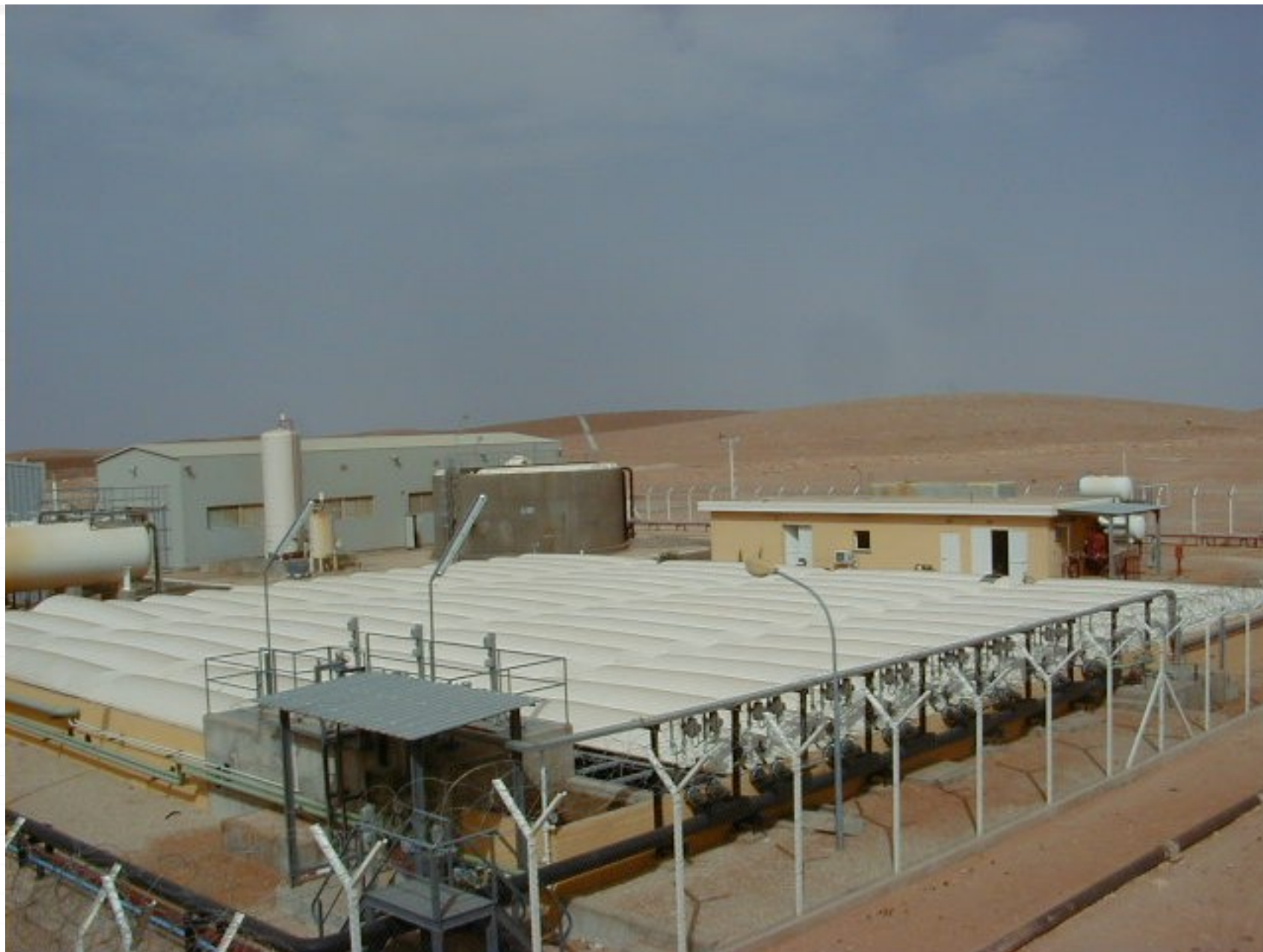
HASSI R'MEL : VUE GENERALE DE L'UNITE DE TRAITEMENT DES EAUX HUILEUSES
