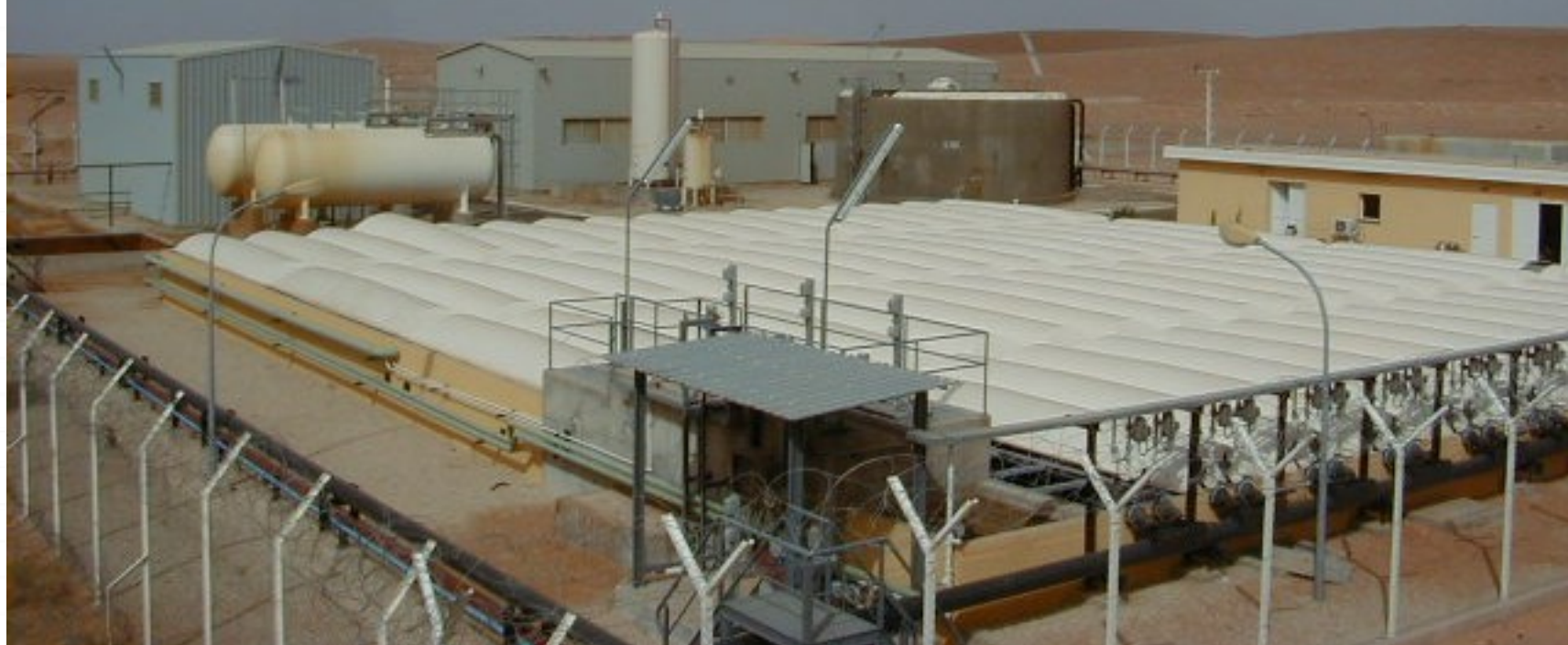
HASSI R'MEL : VUE GENERALE DE L'UNITE DE TRAITEMENT DES EAUX HUILEUSES
