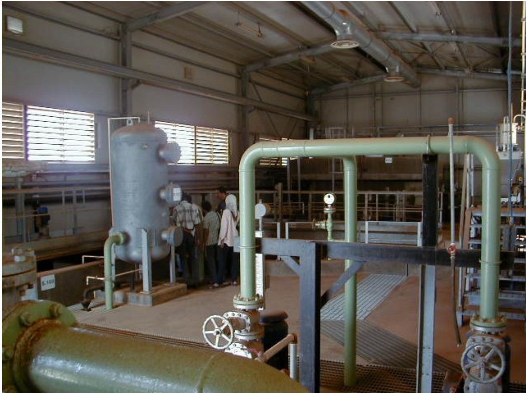
HASSI R'MEL : VUE PARTIELLE DE L'UNITE DE TRAITEMENT DES EAUX HUILEUSES
