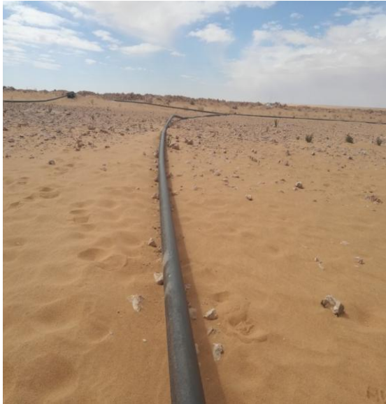
Photo II.10 : La conduite d'alimentation en eau
