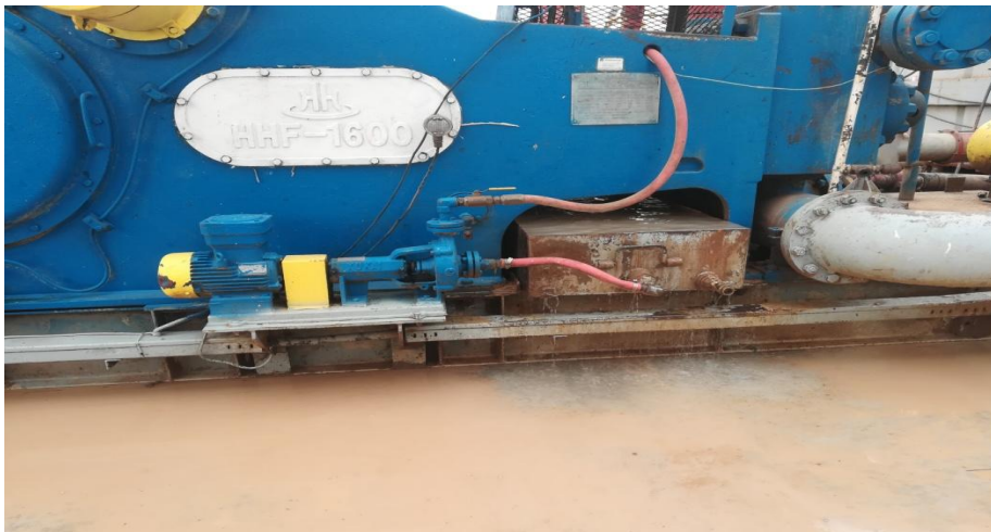
PhotoII.3 : Circuit de refroidissement des pompes [Photo prise le 17/02/19]
