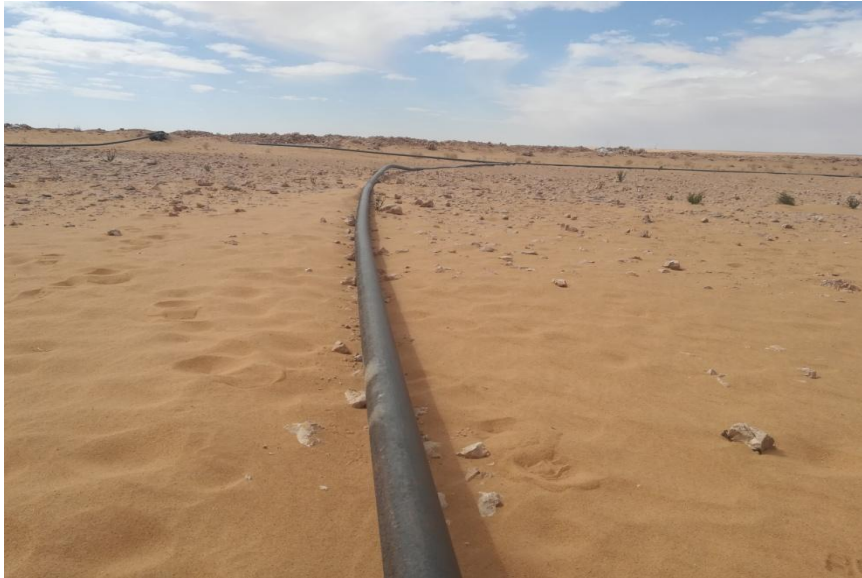
Photo IV.2 : La conduite de transfert d'eau [Photo prise le 03/03/19]
