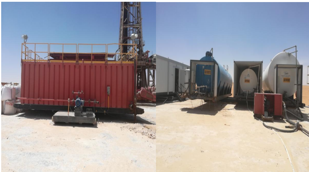
Photo II.8 : Le bac de stockage dans le rig [Photo prise le 22/02/19]
