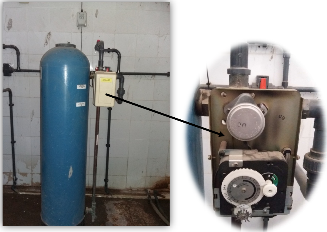
Figure (III.9) : « Filtre à sable » Figure (III.10) : « Boite de contrôle électrique »
