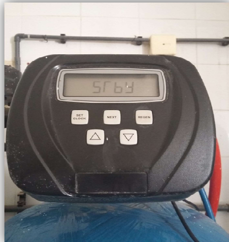
Figure (III.13) : « Boite de contrôle électrique »
