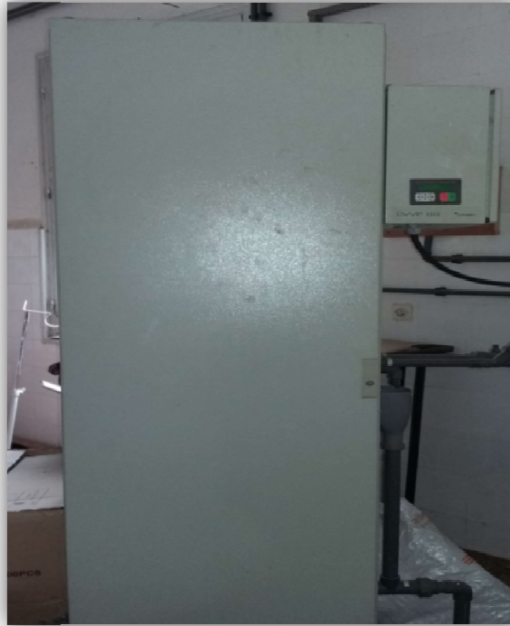
Figure (III.17.1) :« Poste d'osmose inverse fermé »
