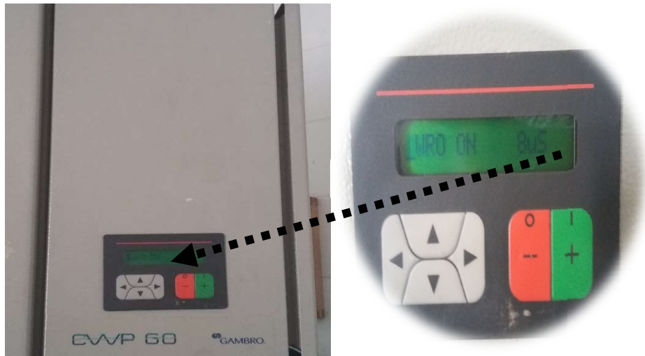
Figure (III.19) : « Module de commande »
