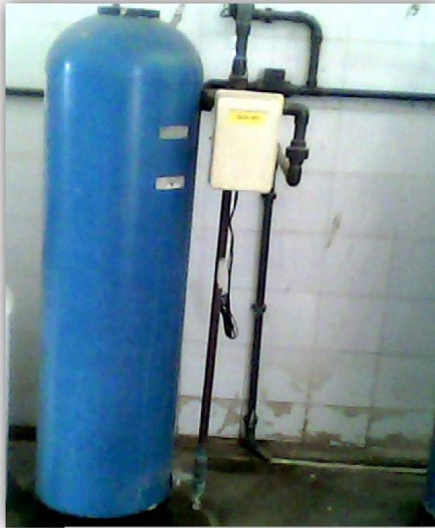
Figure (III.11) : « Filtre à charbon actif »
