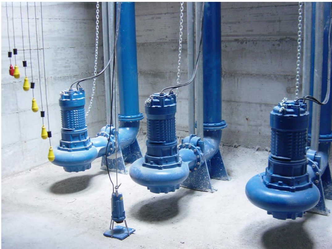
Figure 9.3 : à l'intérieur de puisard 2+1
