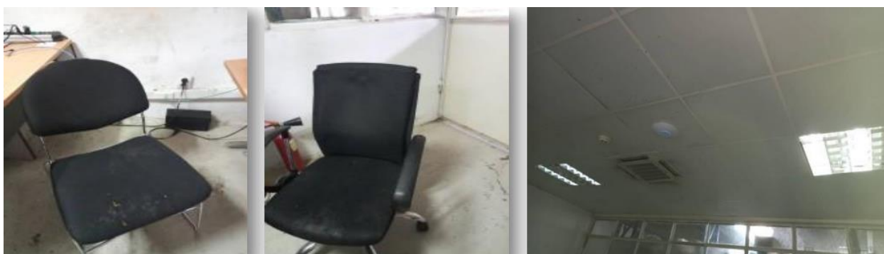
Figure 46 : Conditions de travail défavorable au niveau du bureau de chef de ligne et chargé méthode (manque d'éclairage, des chaises endommagées...). (Photographie originale)
