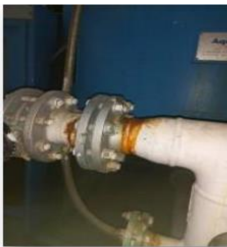
Figure 52 : Présence de la rouille sur la tuyauterie au niveau de station traitement des eaux. (Photographie originale)
