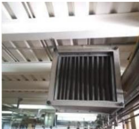
Figure 40 : Présence de saleté au niveau des filtres de convoyeur d'air. (Photographie originale)
