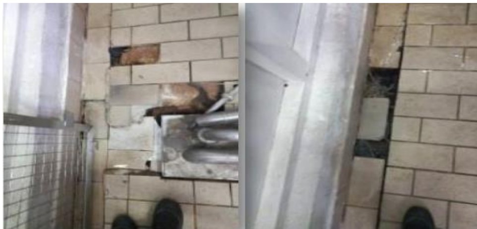
Figure 44 : Sol et caniveau dégradés au niveau de la station NEP PET 02. (Photographie originale)
