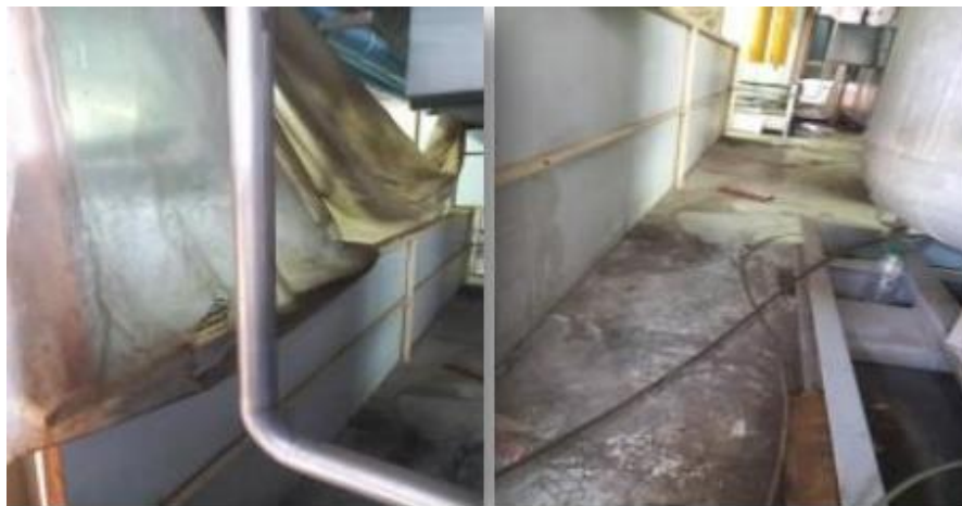
Figure 51 : Présence de la saleté et poussière au niveau de la zone de compresseur (mezzanine PET 02). (Photographie originale)
