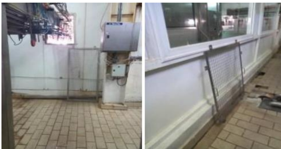
Figure 43 : Les caches de sécurité ne sont pas placés au niveau de la station NEP PET 02. (Photographie originale)
