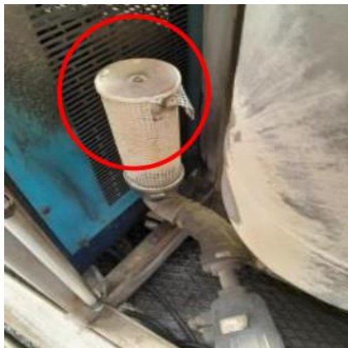
Figure 54 : Deux filtres d'air des compresseurs sont endommagés et non remplacés. (Photographie originale)
