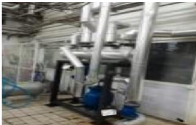
Figure 59 : Installation d'un système de récupération de l'eau de condensat au niveau de la siroperie. (Photographie originale)
