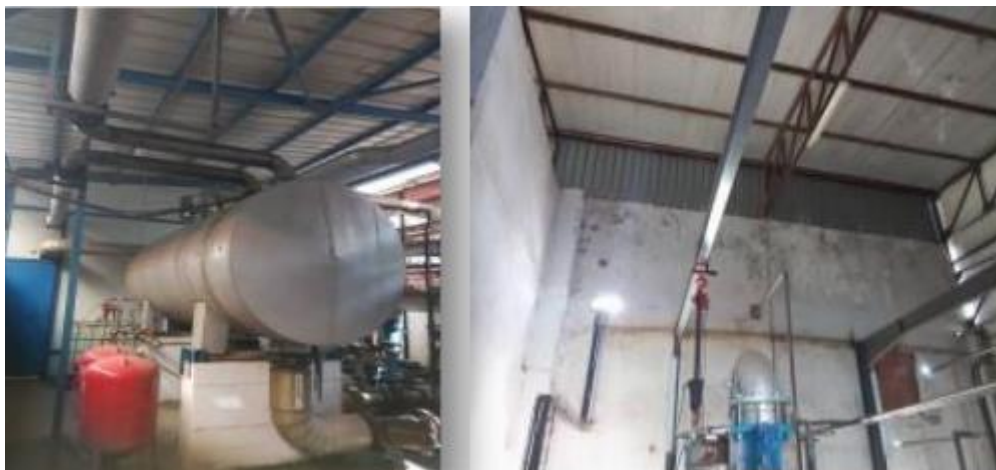
Figure 47 : Dégradation de bâtis de la partie utilité (station traitement des eaux, local chaufferie, local 40 bar). (Photographie originale)
