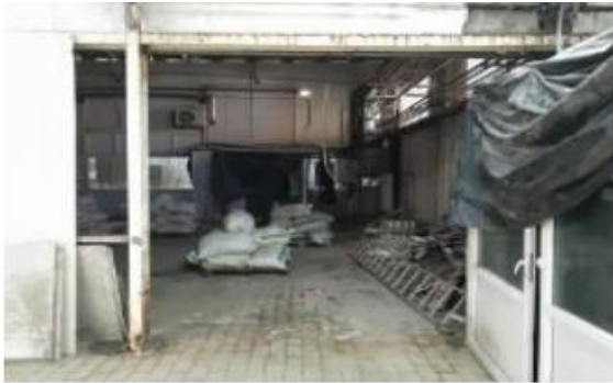
Figure 34 : Absence de séparation entre la zone des travaux et atelier carton (Photographie originale).
