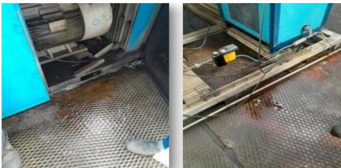
Figure 53 : Présence des huiles déversée au niveau de la zone compresseur PET. (Photographie originale)
