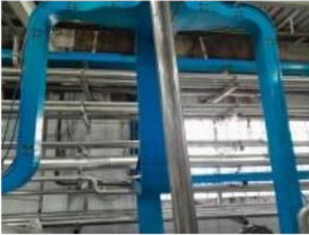
Figure 26 : Mur très souillé et encrassé (Non-respect de BPH). (Photographie originale)
