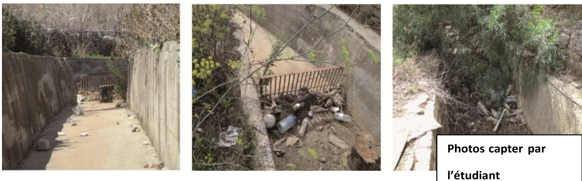
Figure V.1. Le bouchage des canaux
