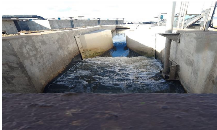
Figure 2.9 : appareil mesure de débit à la sortie de STEP
