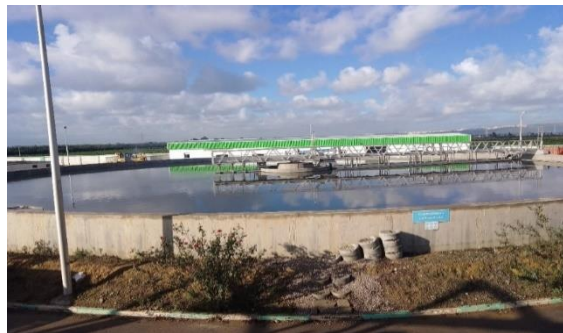
Figure 2.8 : clarificateur de STEP Boufarik
