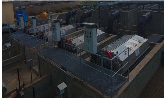
Figure 3.3 : Les 4 filtres mécaniques.
