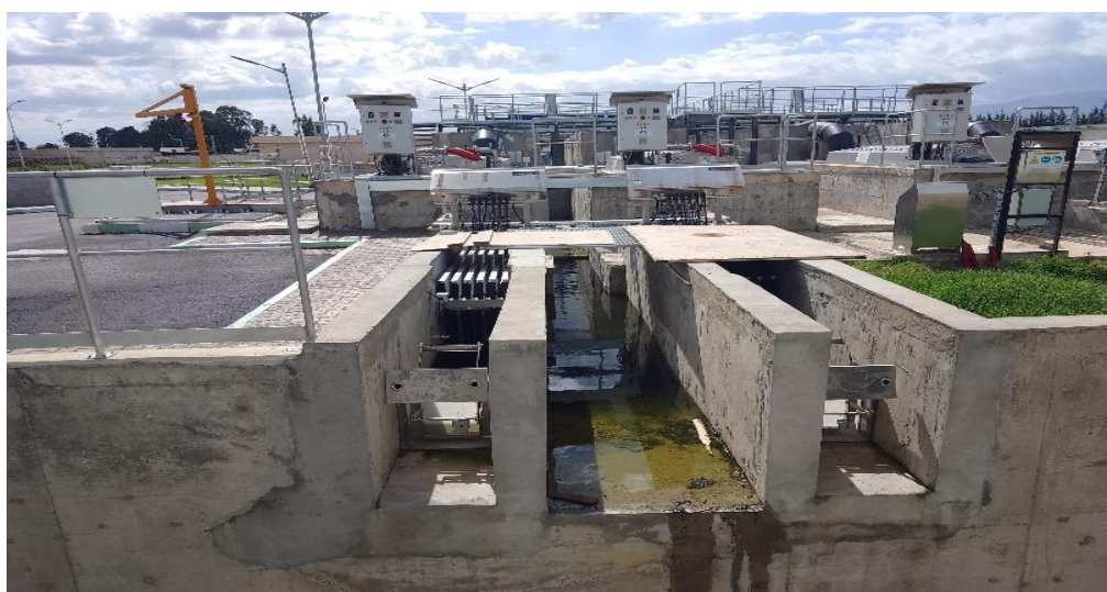
Figure 3.5 : installation de lampes UV en canal ouvert
