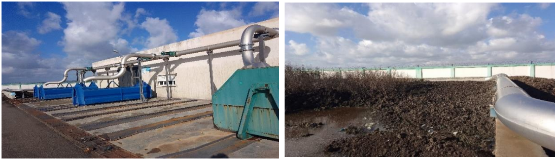
Figure 2.14 : air de stockage
