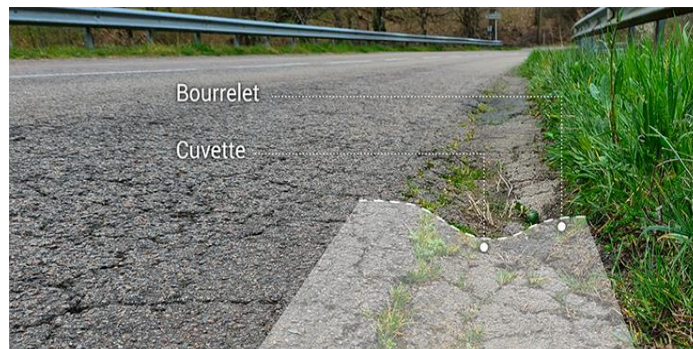
Figure I. 7: Dégradation de chaussée type déformation.
