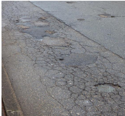
Figure I. 8: Dégradation de type arrachement.
