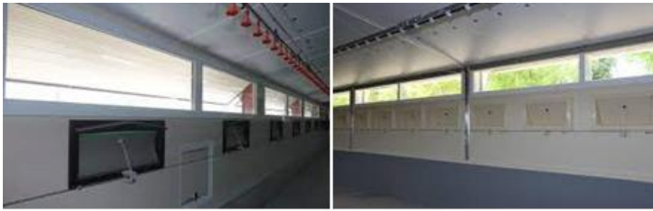
Figure 3: Bâtiments à ventilation naturel(29).
