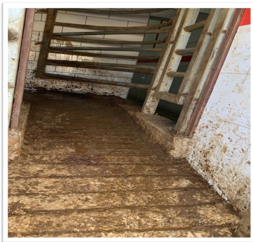
Figure 15 : Sol et paroi d'amené souillés
