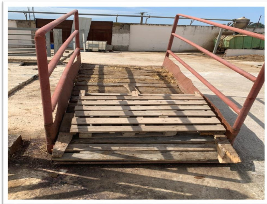
Figure 12 : quai de débarquement non conforme
