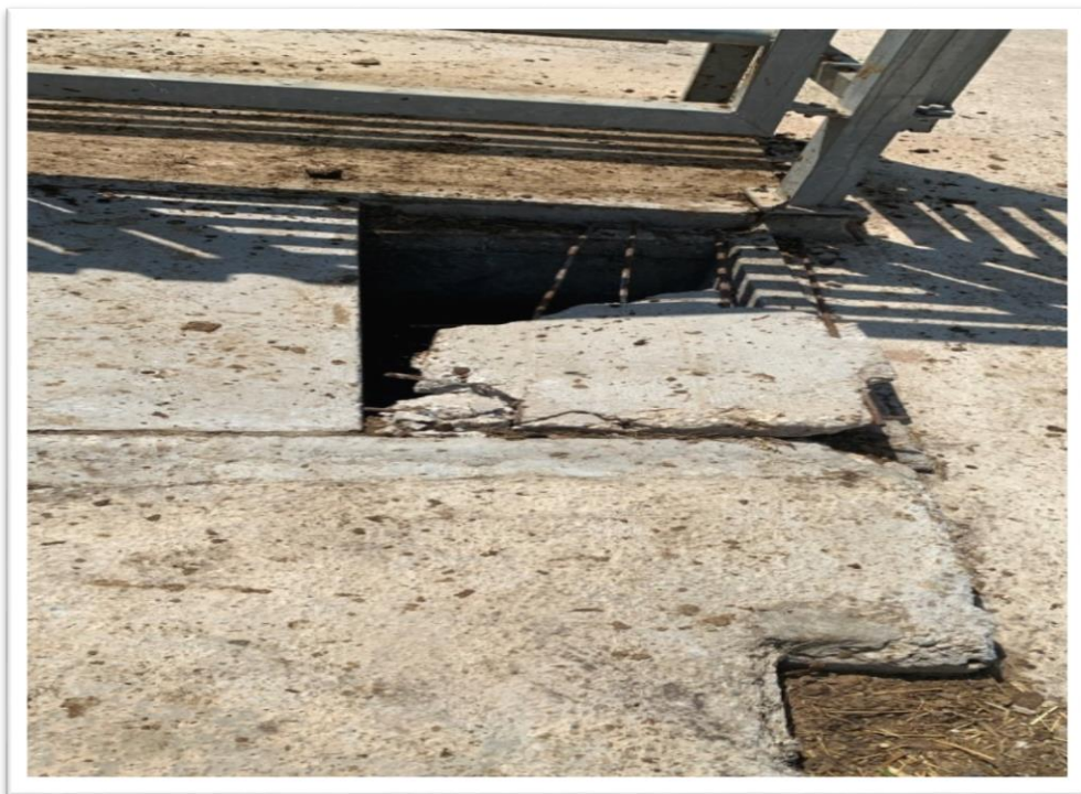
Figure 14 : fosse des canaux d'égout proche de stabulation
