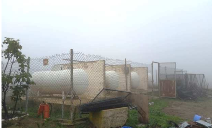
Figure 6 : Vue de profil de 4 citernes à gaz (photo personnelle)
