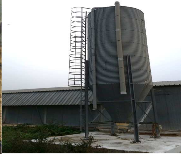
Figure 9 : silos d'aliment (photo personnelle)
