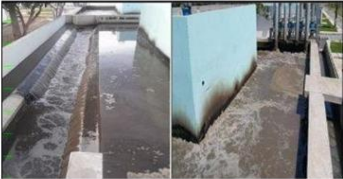
Figure 1.4 : Bassin d'aération de la STEP de Beni Merad (Photo original 2024).
