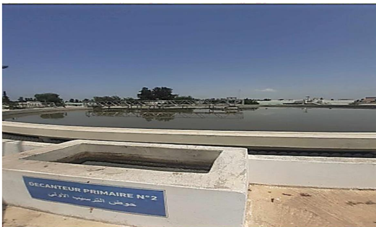
Figure 1.3 : Décanteur primaire (Photo original 2024)
