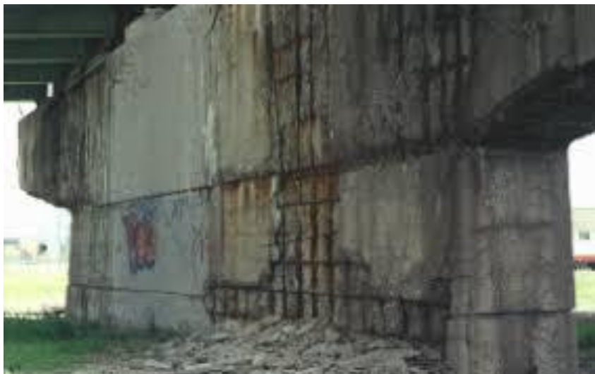
Figure I.5 : Attaque de sulfates sur le béton [4]
