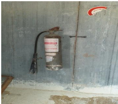
Figure 16 : extincteur dans l'entrée de bâtiment (photo perso, 2019)
