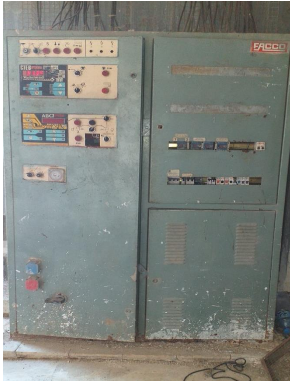
Figure 18: armoire électronique à l’entrée de bâtiment (photo perso, 2019)
