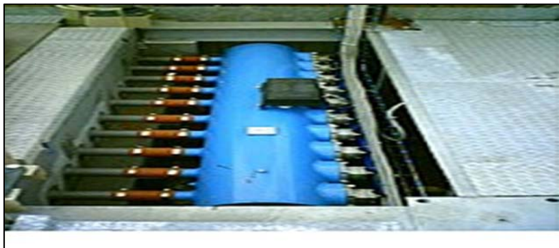
Figure 2-2 : Réservoir à air comprimé de décolmatage.
