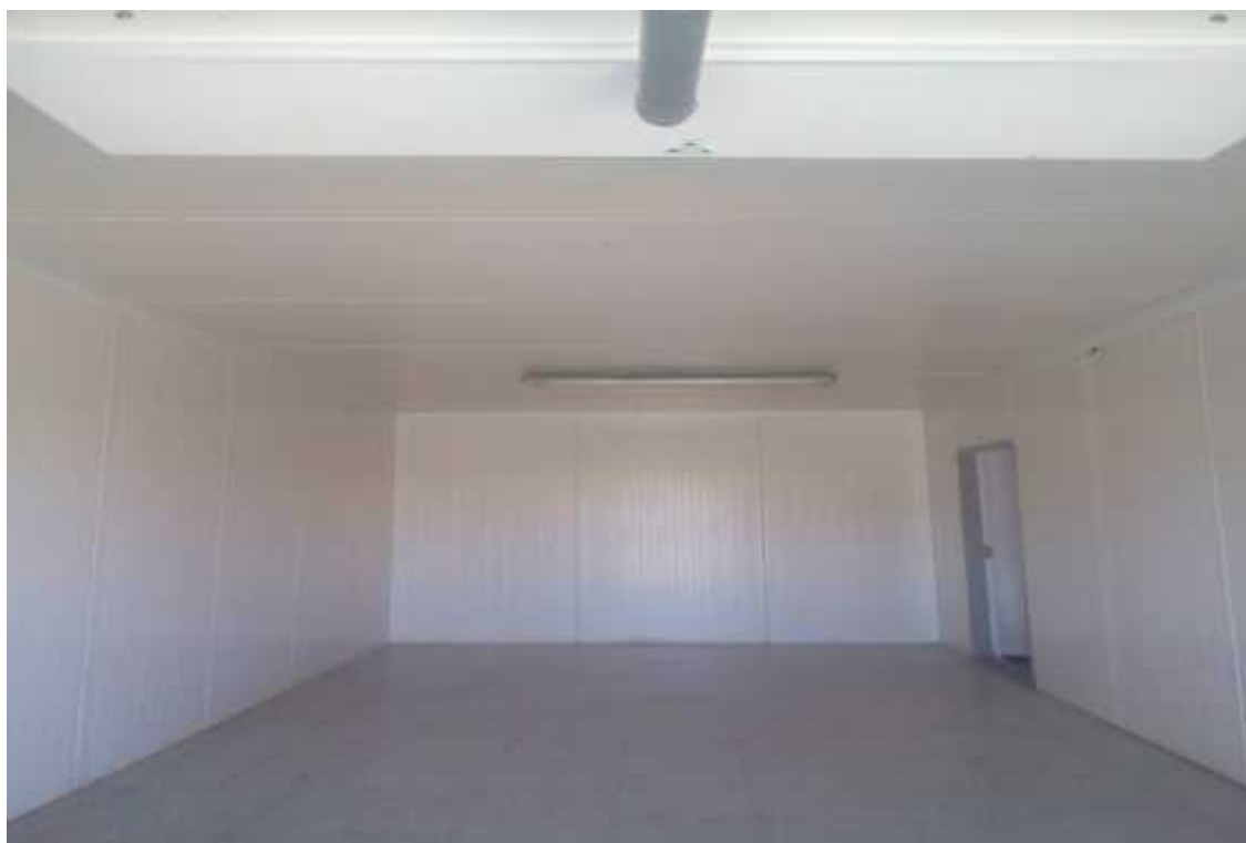
Figure (41) : chambre froide.
