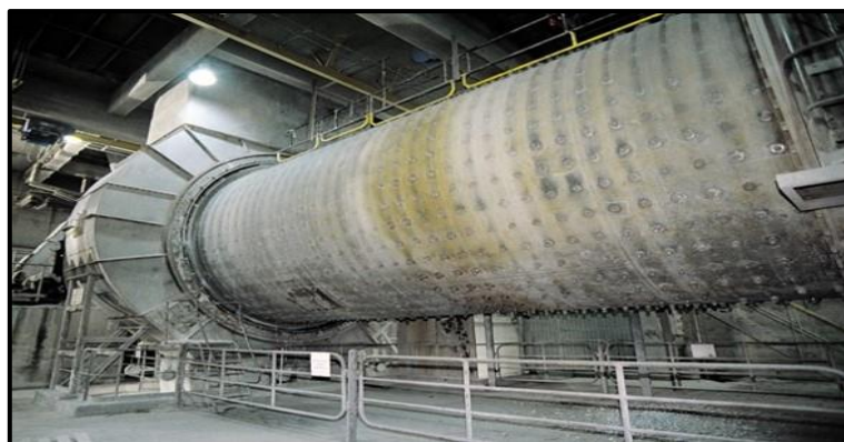
Figure 1-7 : Broyeur à boulets [6]
