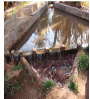
Figure 20 : Répartiteurs d'eau secondaires Source INSID
