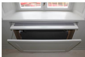
Refroidissement et chauffage avec ventilo-convecteurs
