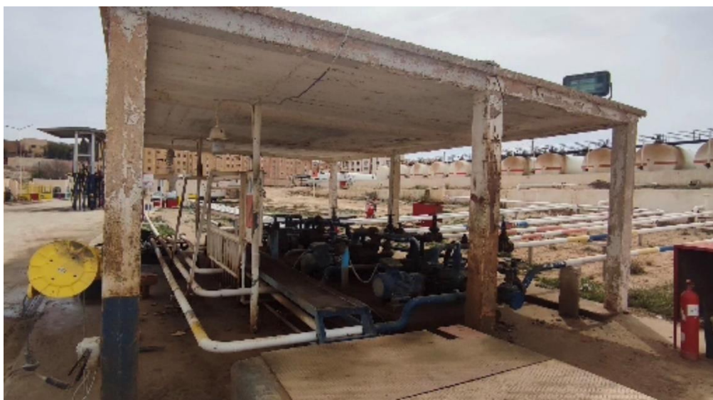
Figure 3. 2 Ancienne salle des pompes
