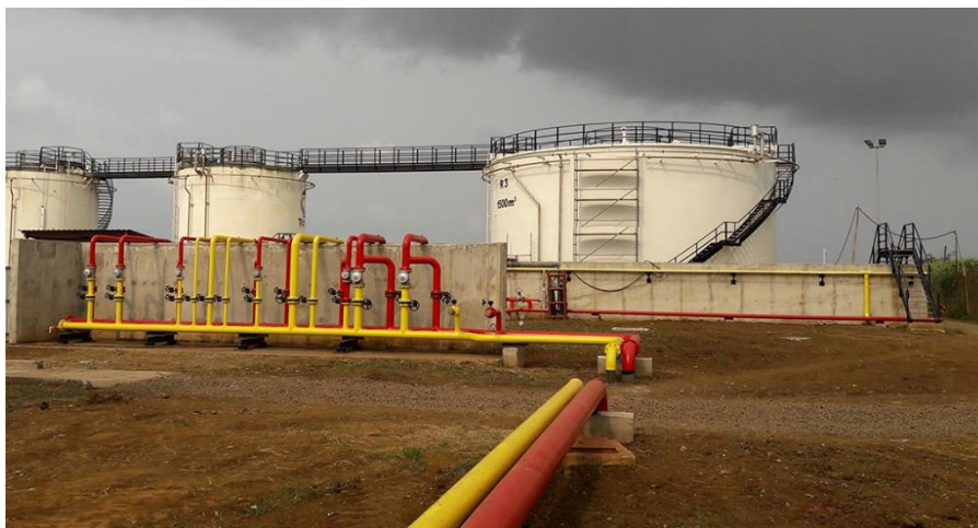
Figure 1. 4: Réservoirs de Stockage d'hydrocarbure
