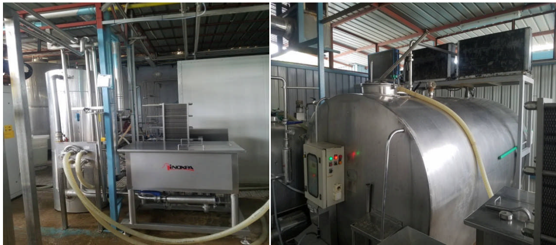
Figure 8 : Station de réception et de stockage du lait.
