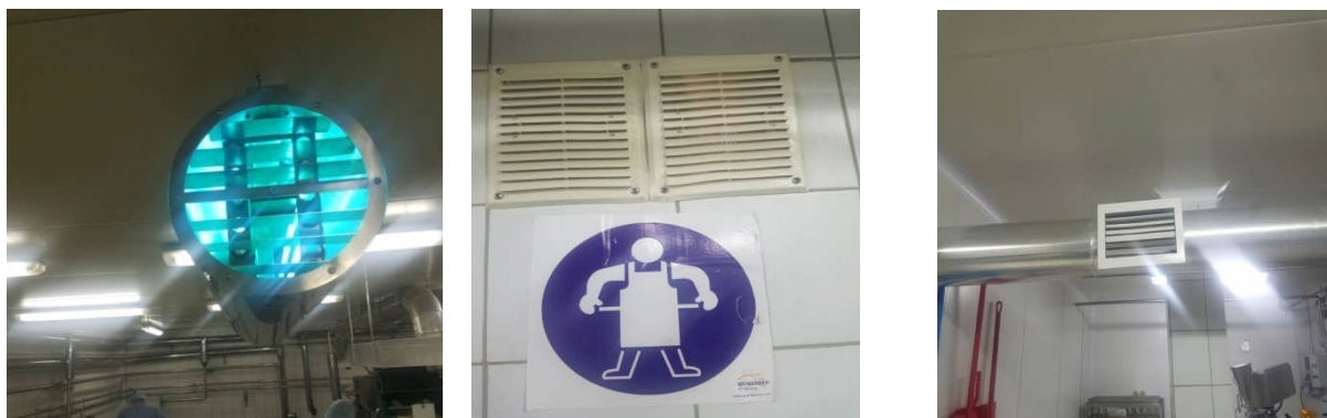
Figure 15 : Stérilisateur d'air (UV) /Filtre/ Extracteur d'air
