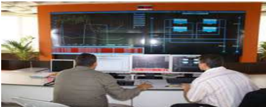
Figure 1.3 : Supervision Topkapi télécontrôle de SEAAL [1].
