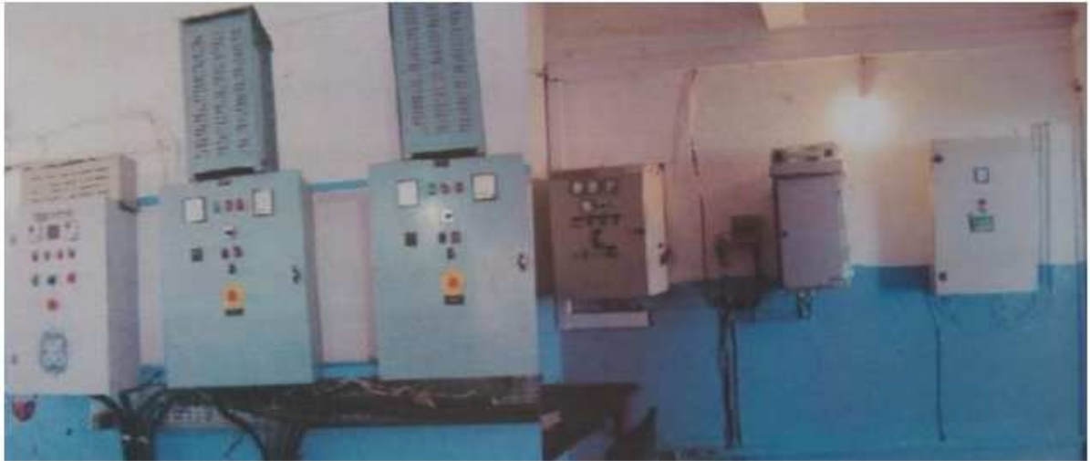
Figure 1.9 : exemple de Vue d'une salle de commande [1].
