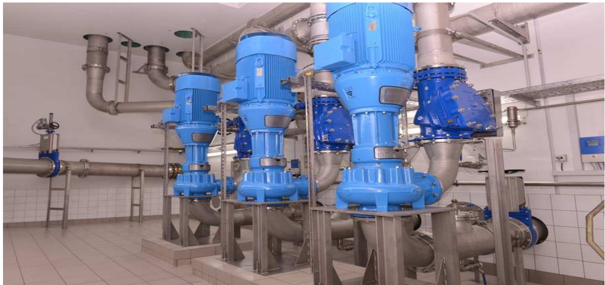
Figure 1.6 : groupes de pompage.
