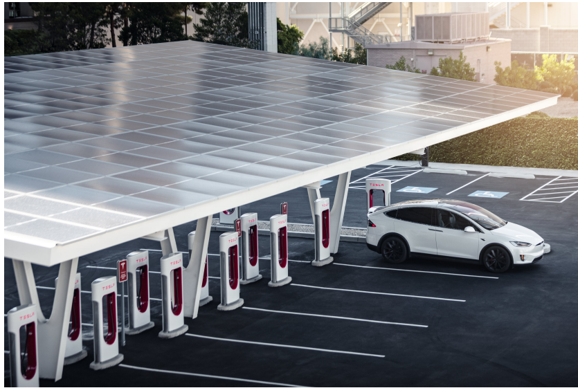
Figure 2.1: borne de recharge pour véhicules électriques Tesla de nouvelle génération
