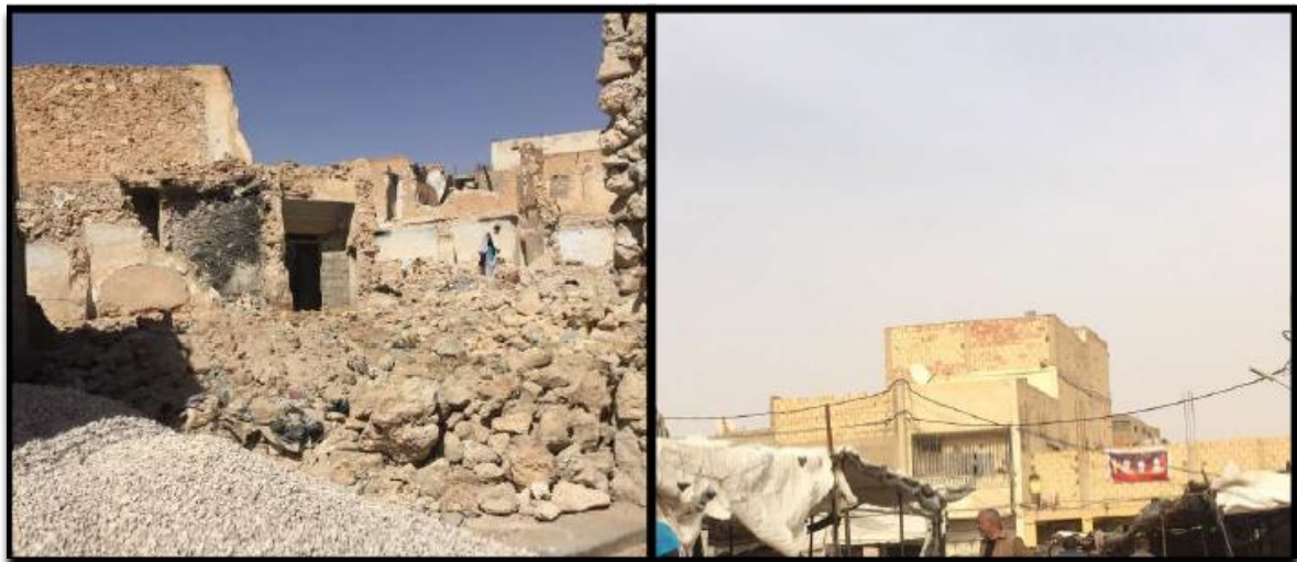
Fig94 : Bâtiment effondré et délaissé Source : auteur 2018
