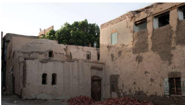
Fig41 : Habitation en dégradation à Gournà Source : https://whc.unesco.org/
