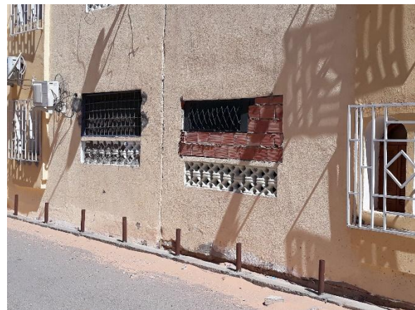
Fig 57 : ouverture partiellement fermée au niveau d'un logement au RDC Source : Auteurs-Mai 2018
